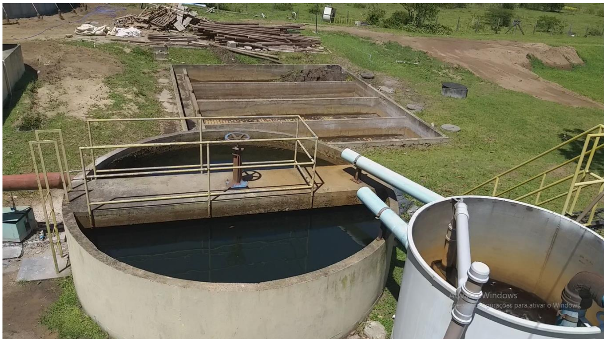
Figura 44: UTR – decantador e leitos de secagem – vista geral.
