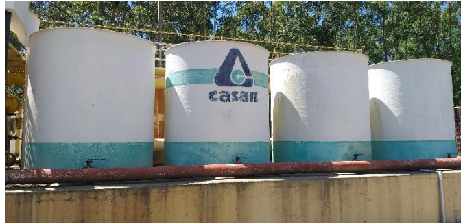
Figura 24: Decantadores –vista geral.
