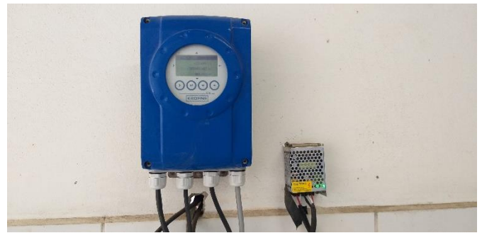
Figura 57: Laboratório – display do macromedidor da adutora de água tratada.
