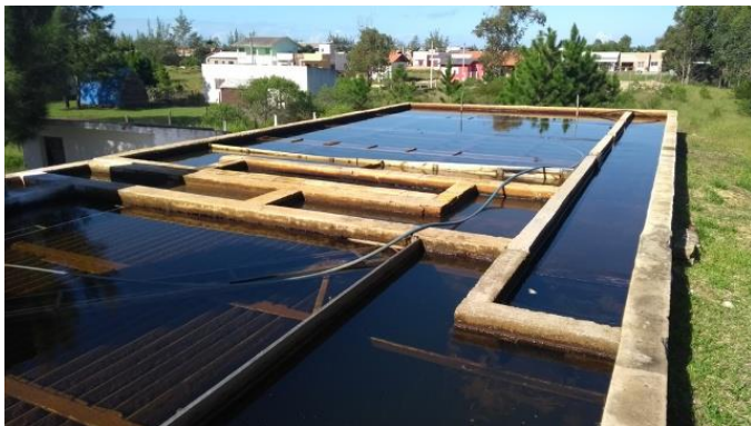
Figura 105: ETA – Unidades hidráulicas
