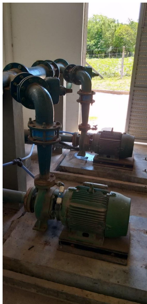
Figura 86: ERAT – Conjuntos moto-bombas – vista geral.
