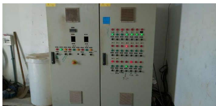
Figura 85: ERAT – Quadros de comando elétrico.
