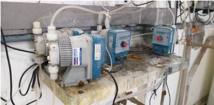
Figura 74: Sala de dosagem de produtos químicos – bombas dosadoras.
