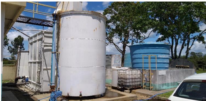
Figura 37: – Floculador – vista externa
