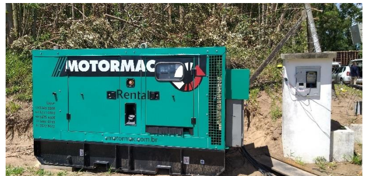
Figura 78: Gerador de energia elétrica - Vista geral.
