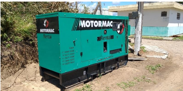
Figura 77: Gerador de energia elétrica - Vista geral.
