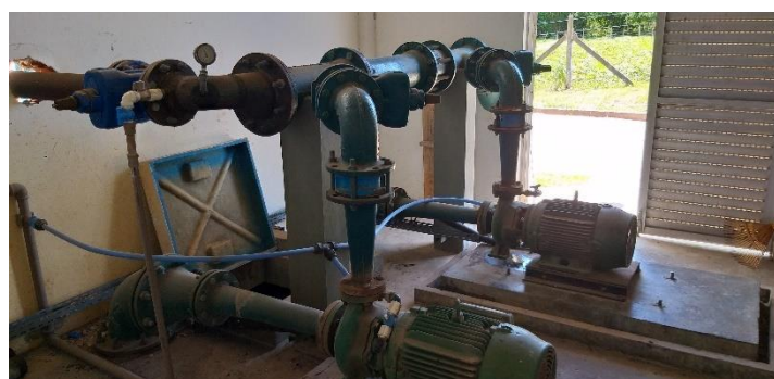
Figura 84: ERAT – Conjuntos moto-bombas – vista geral.
