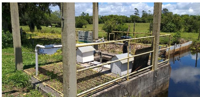
Figura 10: Captação Estiva do Rodrigues – ERAB – estação de recalque de água bruta.
