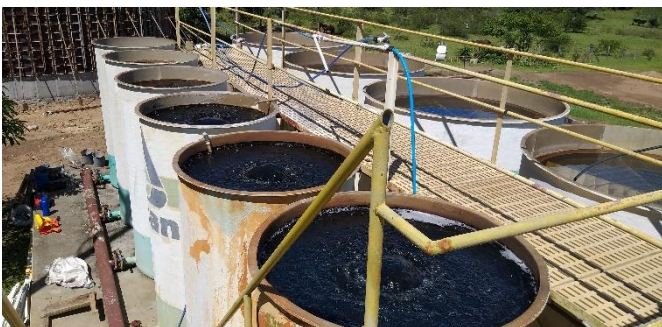
Figura 29: Flocladores – Vista geral seguidas lateralmente com os decantadores.
