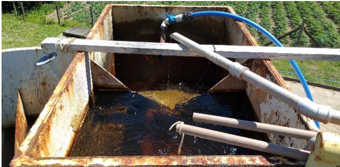
Figura 36: Caixa de chegada e medidor triangular de vazões.
