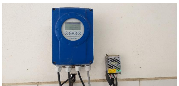
Figura 90: ERAT – Macromedidor – display de leitura de vazões..
