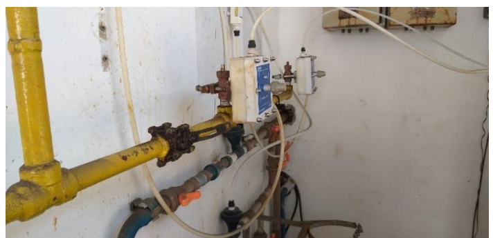
Figura 61: Casa de Cloro – dispositivos de controle.
