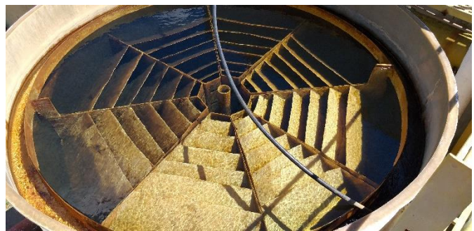
Figura 26: Decantadores –vista do sistema lamelar.
