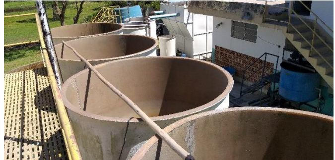
Figura 32: Filtros - Vista geral do conjunto de unidades
