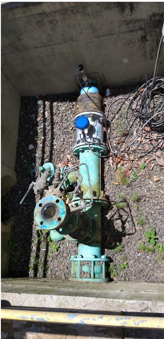
Figura 87: ERAT – Macromedidor – vista geral.
