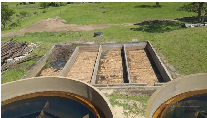
Figura 49: Leitos de Secagem do lodo – vista geral.
