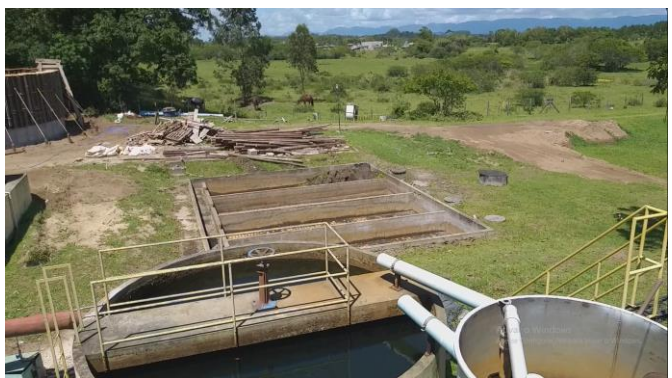
Figura 50: Leitos de Secagem do lodo – vista geral.
