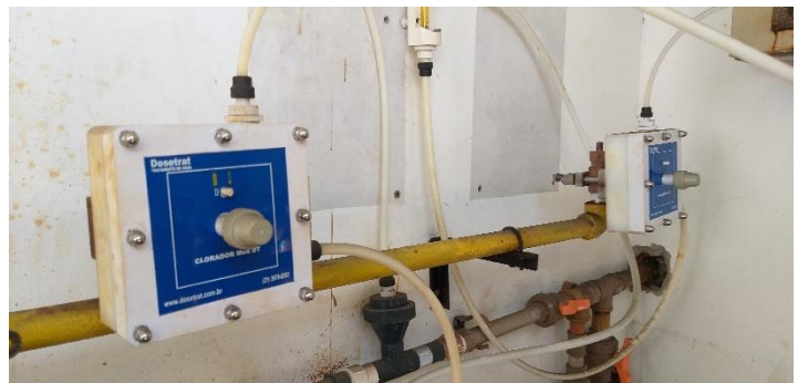
Figura 60: Casa de Cloro – dispositivos de controle.
