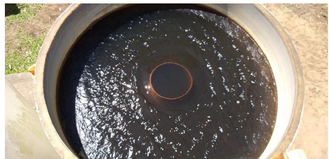
Figura 30: Flocladores – Vista unificada.
