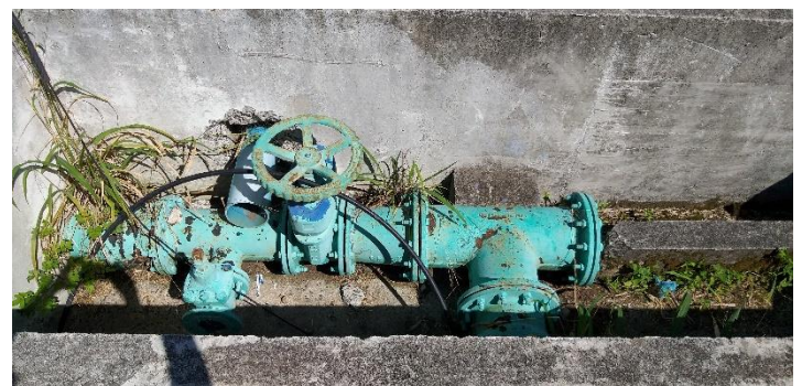
Figura 94: Reservatório elevado – caixa de manobras/registros.
