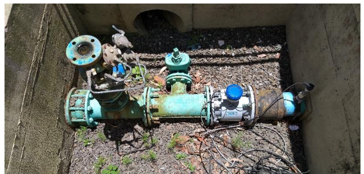
Figura 89: ERAT – Macromedidor – vista geral.
