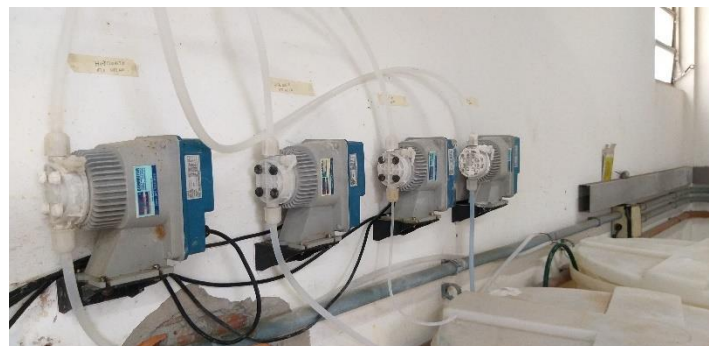
Figura 73: Sala de dosagem de produtos químicos – bombas dosadoras
