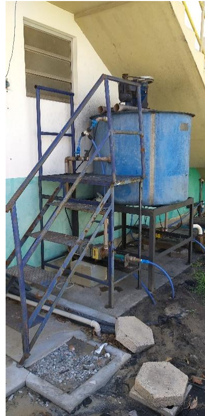
Figura 76: Sala de dosagem de produtos químicos – misturador de carvão ativado.
