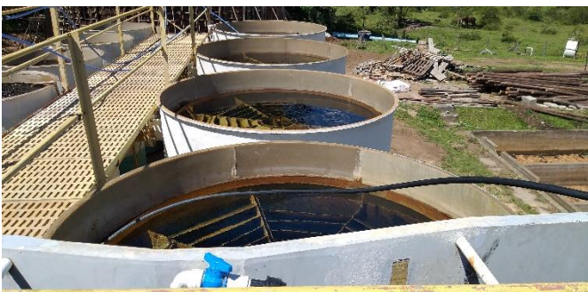
Figura 25: Decantadores –vista geral.
