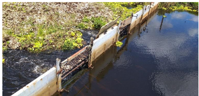
Figura 9: Captação Estiva do Rodrigues – Barragem de Nível.
