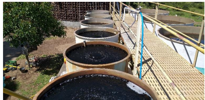
Figura 28: Flocladores – Vista geral.
