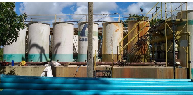
Figura 27: Flocladores – Vista geral.
