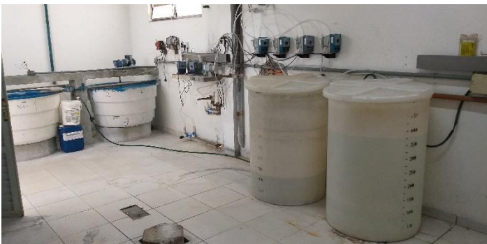
Figura 70: Sala de dosagem de produtos químicos – vista geral
