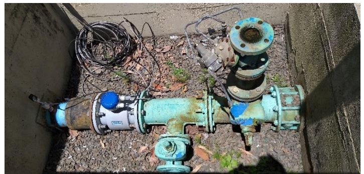
Figura 88: ERAT – Macromedidor – vista geral.
