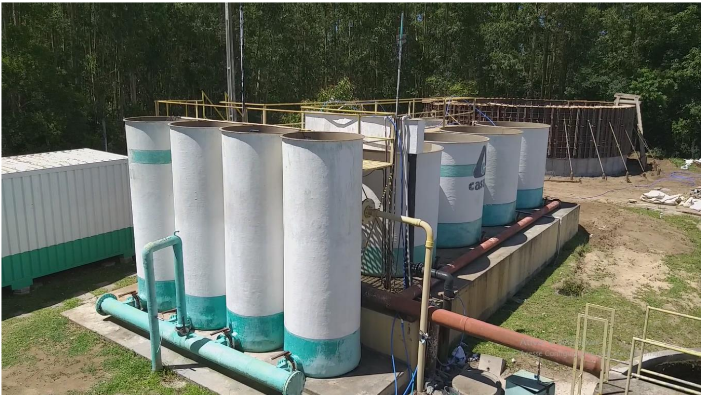
Figura 22: Módulo Compacto Aberto em Fibra – vista geral.
