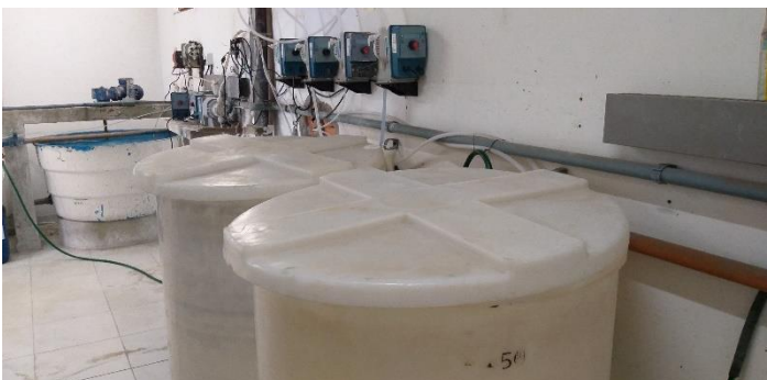
Figura 72: Sala de dosagem de produtos químicos – tanques de barrilha e hipoclorito de sódio.
