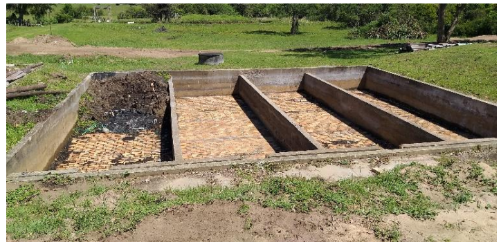
Figura 48: Leitos de Secagem do lodo – vista geral.
