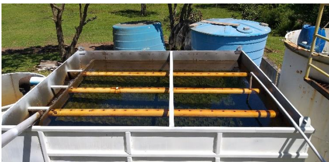
Figura 40: Decantador – vista geral.
