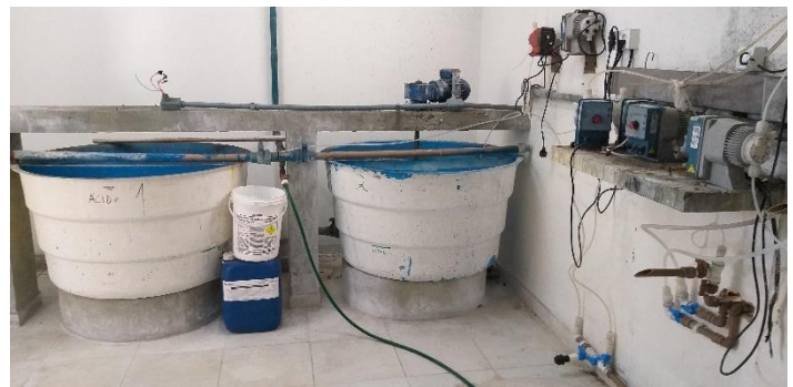
Figura 71: Sala de dosagem de produtos químicos - tintas de ortofosfato e ácido fluossilícico.
