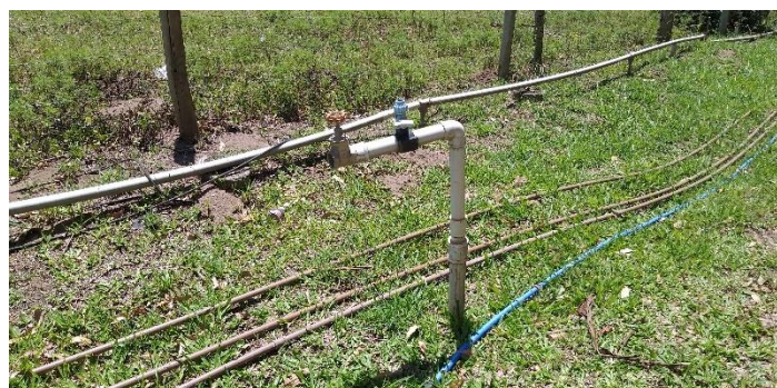
Figura 17: Sistema de ponteiros – tubulação para acoplamento ocasional ao bombeamento do sistema.
