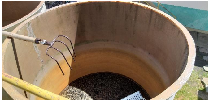
Figura 34: Filtros - Vista unificada.
