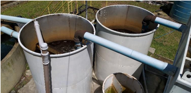
Figura 42: Filtros - Vista geral.
