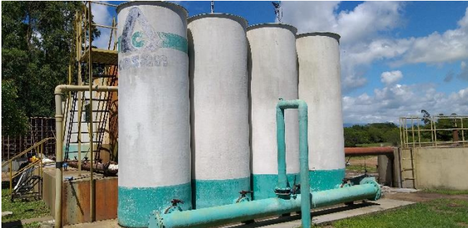
Figura 31: Filtros - Vista geral do conjunto de unidades.
