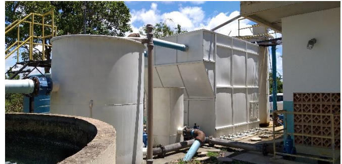
Figura 43: Filtros – Vista externa - anexos ao decantador.
