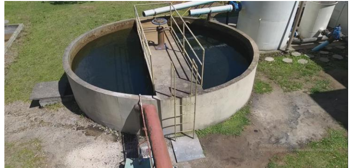
Figura 46: Decantador – vista geral - sistema hidráulico do lodo proveniente dos filtros de ambos os módulos de tratamento de água.
