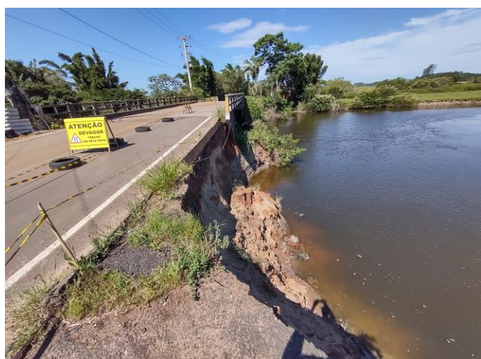
IMAGEM 03 - LOCAL COM MAIOR EROSÃO
